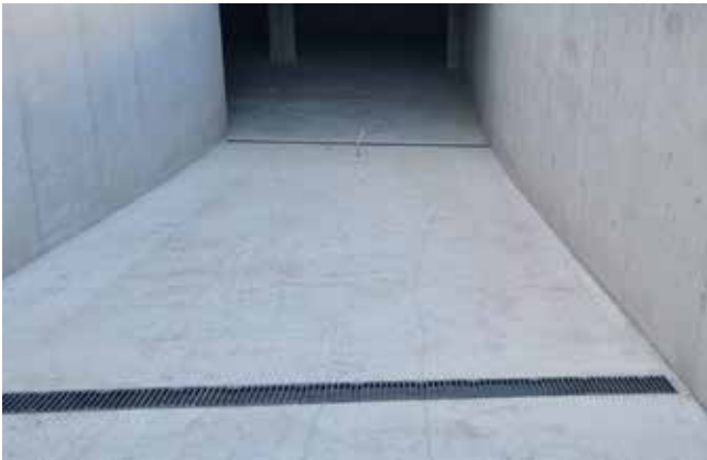
Rampenauffahrt: 150V-Line mit Gusseisenrost
